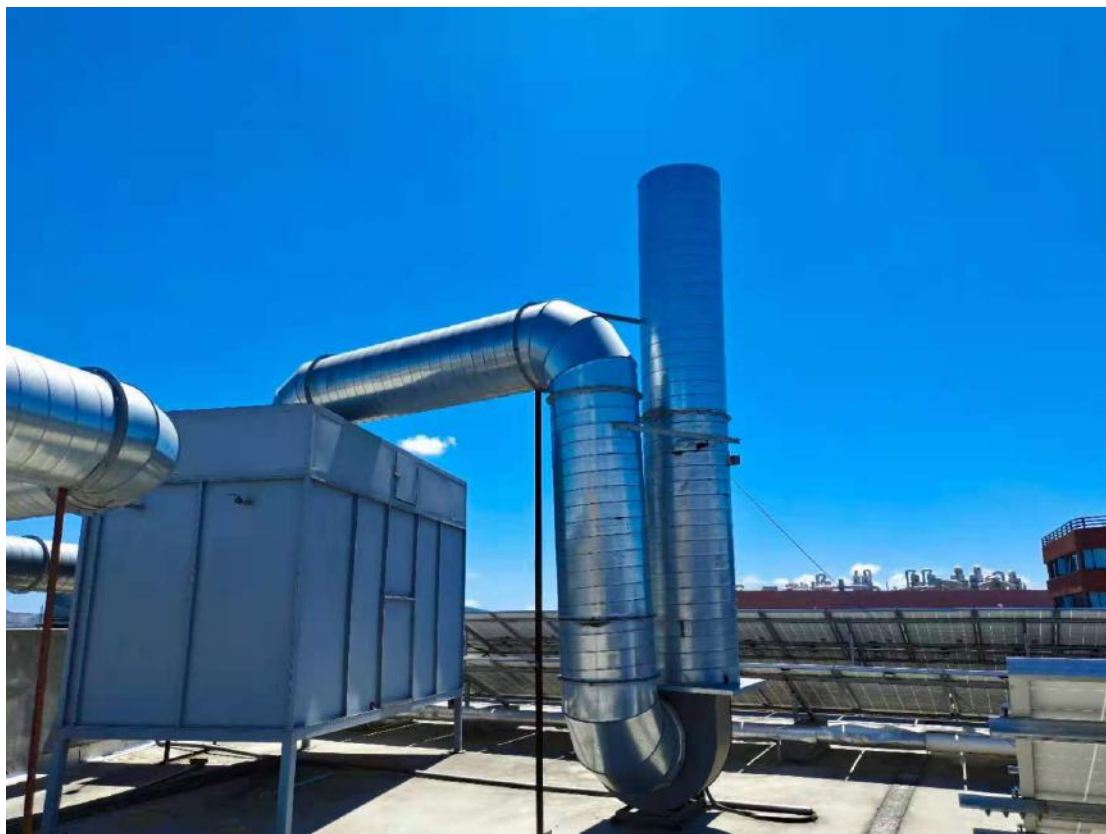
粉尘处理设施（除尘器）
